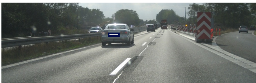
Figur 8.7 Eksempel på belægning med ar efter fjernet kørebaneafmærkning.
