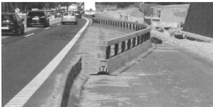
Figur 7.10 Eksempel på påkørt trafikværn med manglende forankring, overlap eller koblingselementer.
