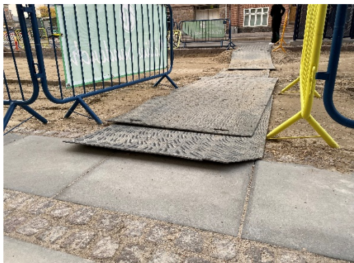
Figur 7.30 Eksempel på køreplade der ikke er udlagt korrekt.
